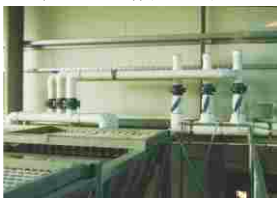
Станция очистки воды, Витково, Польша
